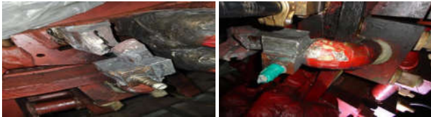
图3 接地电弧烧损
