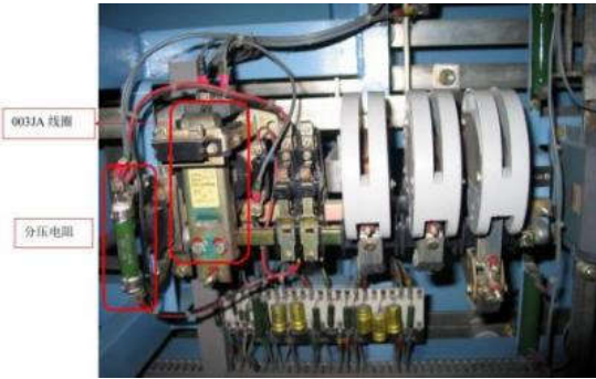
图3 LNE逆变器003JA现场安装图片
