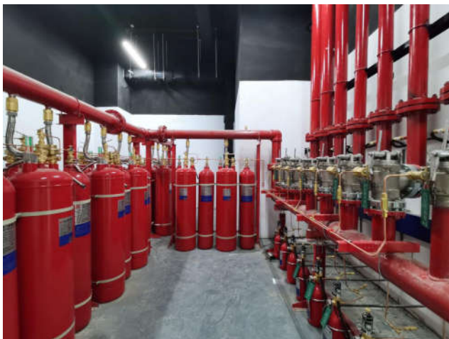
图2 中国电信杭州大数据中心外贮压七氟丙烷灭火系统瓶组间实拍图
