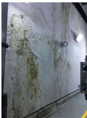
图1 某地下变电站设备房间渗漏水状况
