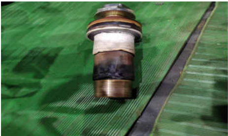
图2 导电螺钉绝缘套管过热损伤
