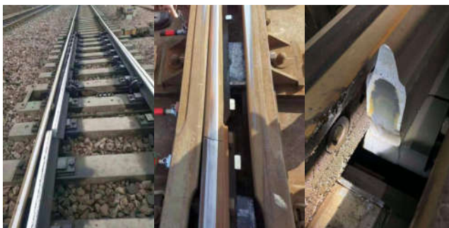
图1 铁路道岔钢轨折断
