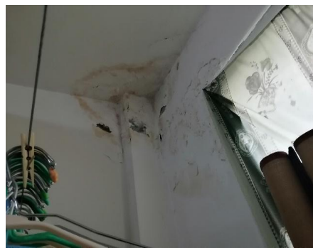
图4 第五层顶层室内渗水
