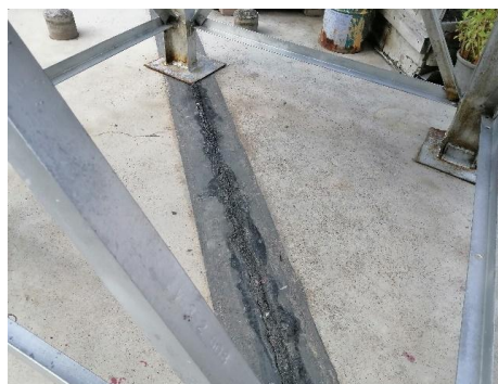
图3 建筑屋面防水开裂
