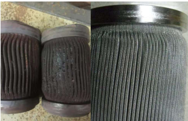
图4 1000MW机组再热器喷水过滤器堵塞与新过滤器对比图
