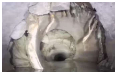
图2 管道破裂、错口缺陷示例图
