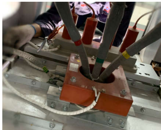
图1: 高压电动机零序电流互感器实际位置
