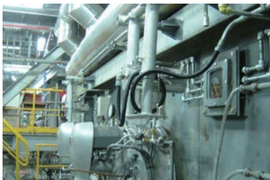
图2 某火力发电厂锅炉
