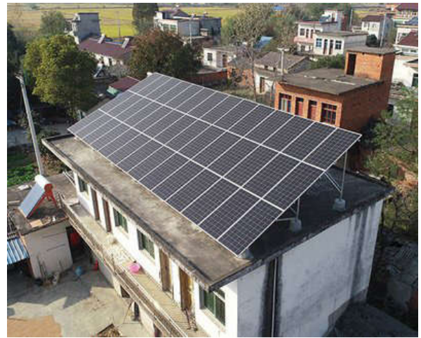
图1 独立光伏发电系统在农村的应用
