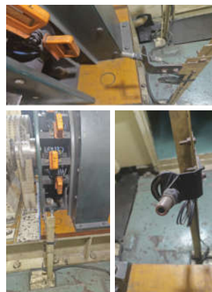
图3-1 发电机集电环在线非接触式红外线测温装置
