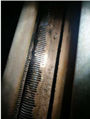
图3 加热器换热管冲洗前实物图
