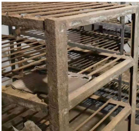
(b) 打磨除锈后未喷涂“科来新”防腐材料半年后状况
