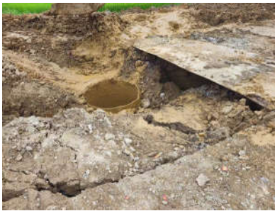
图3 漏浆、塌孔引起的地面塌陷
