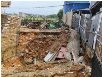
图4 桩位130m外房屋基础塌陷
