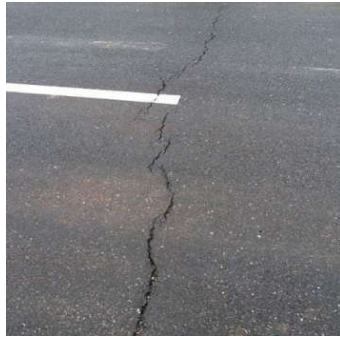
图1 沥青路面横向裂缝
