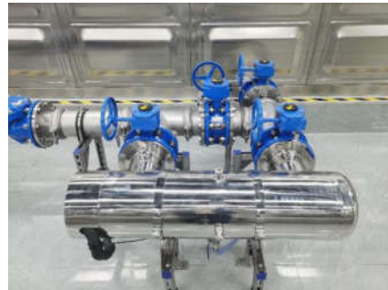
图2.3.1 昆山二次供水泵房水箱出水口紫外线杀菌模块
