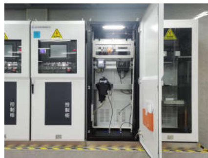
图2.5.2 昆山二次供水水质在线监测控制柜
