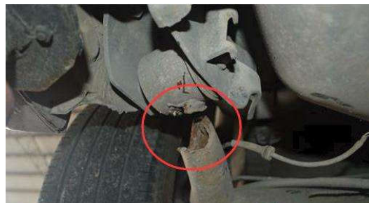
图3 焊接氧化断裂
