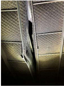
图1 除雾器损坏图
